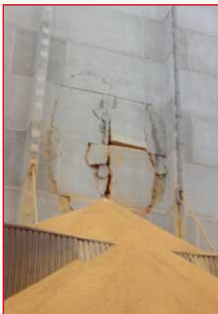
Figuur 4: Beschadiging van een wand van een betonnen silo door een combinatie van een toenemend drukk niveau en lokale piekspanningen
