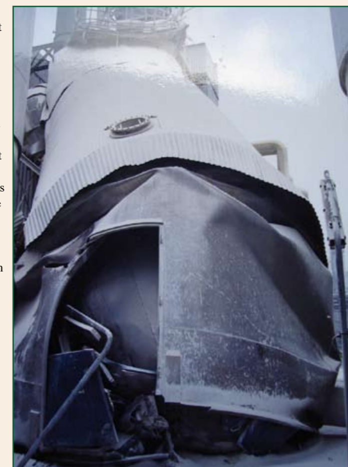
Figuur 3: Voorbeeld van een bezwaken silo. Ondanks toegenomen kennis over de belastingen gaat het nog wel eens mis.
